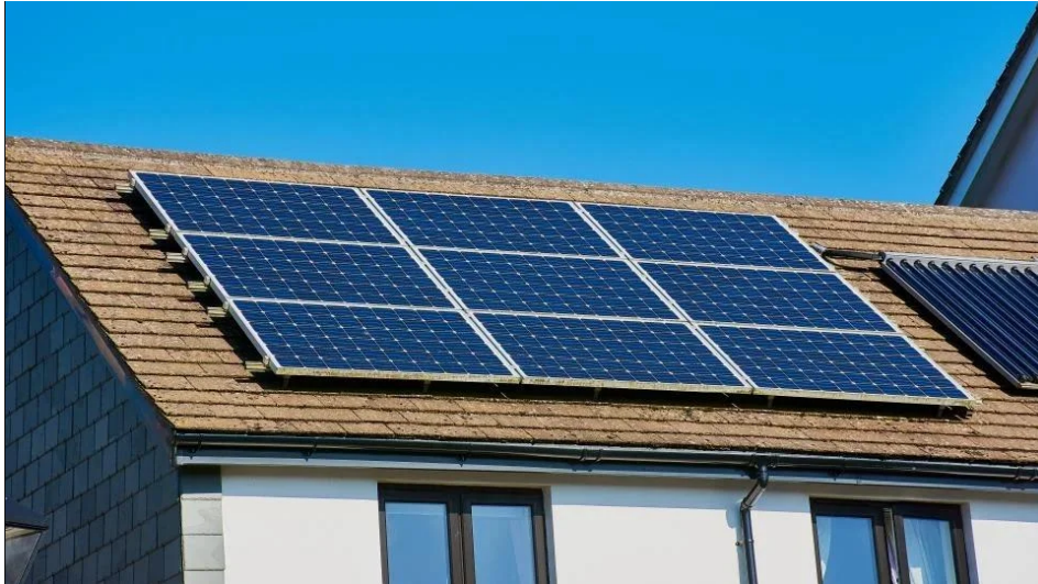
Slika 7 Krovni fotonaponski paneli
