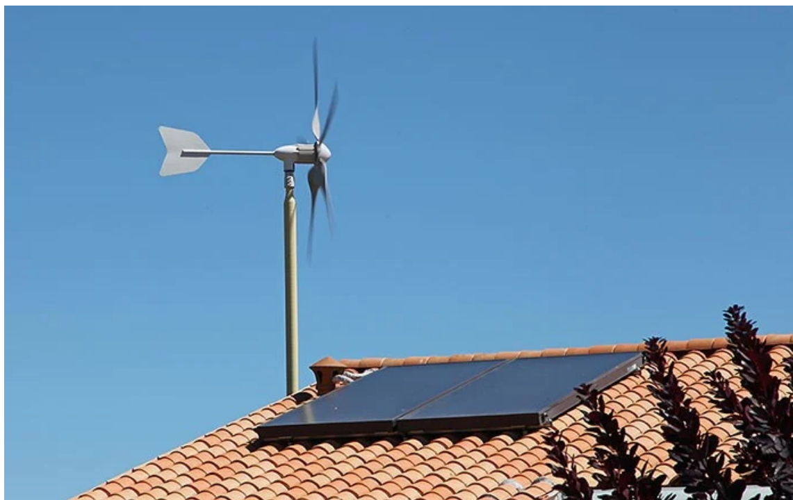
Slika 2 Osobna proizvodnja energije preko solarnih panela i vjetroturbine
