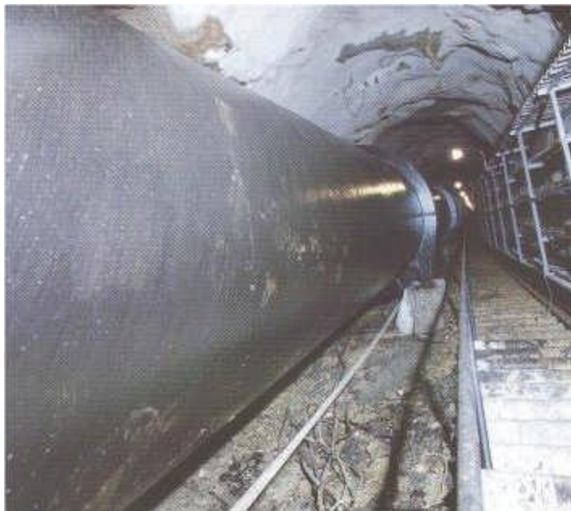
Slika 3.3. Tlačni cjevovod na Hidroelektrani Rijeka [24]
