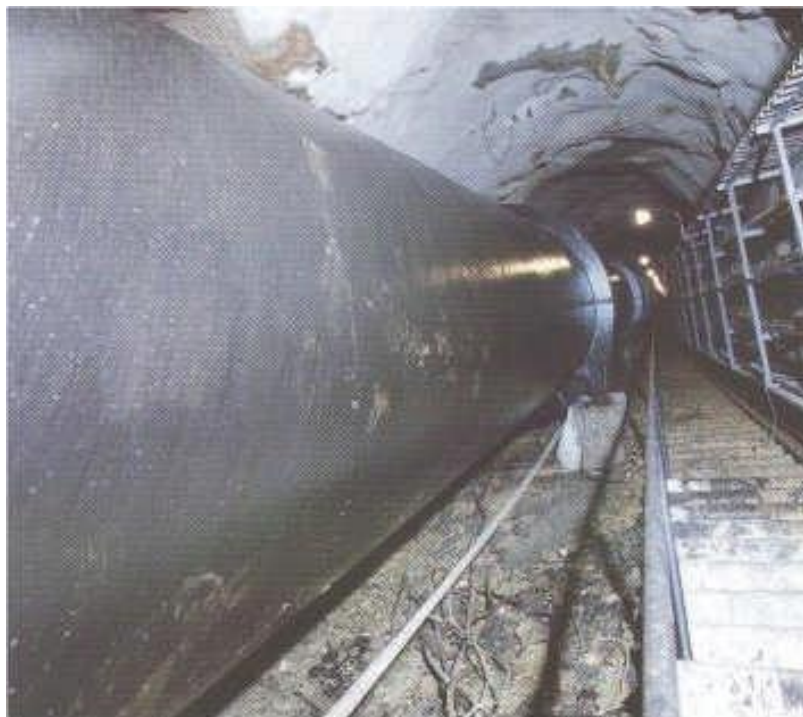
Slika 3.3. Tlačni cjevovod na Hidroelektrani Rijeka [24]
