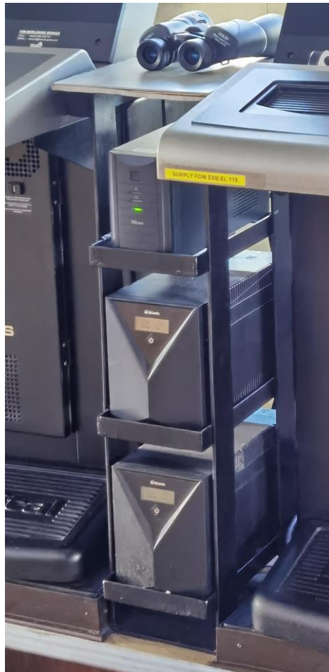
Slika 3.1. UPS napajanje za izvanredne situacije na mostu
