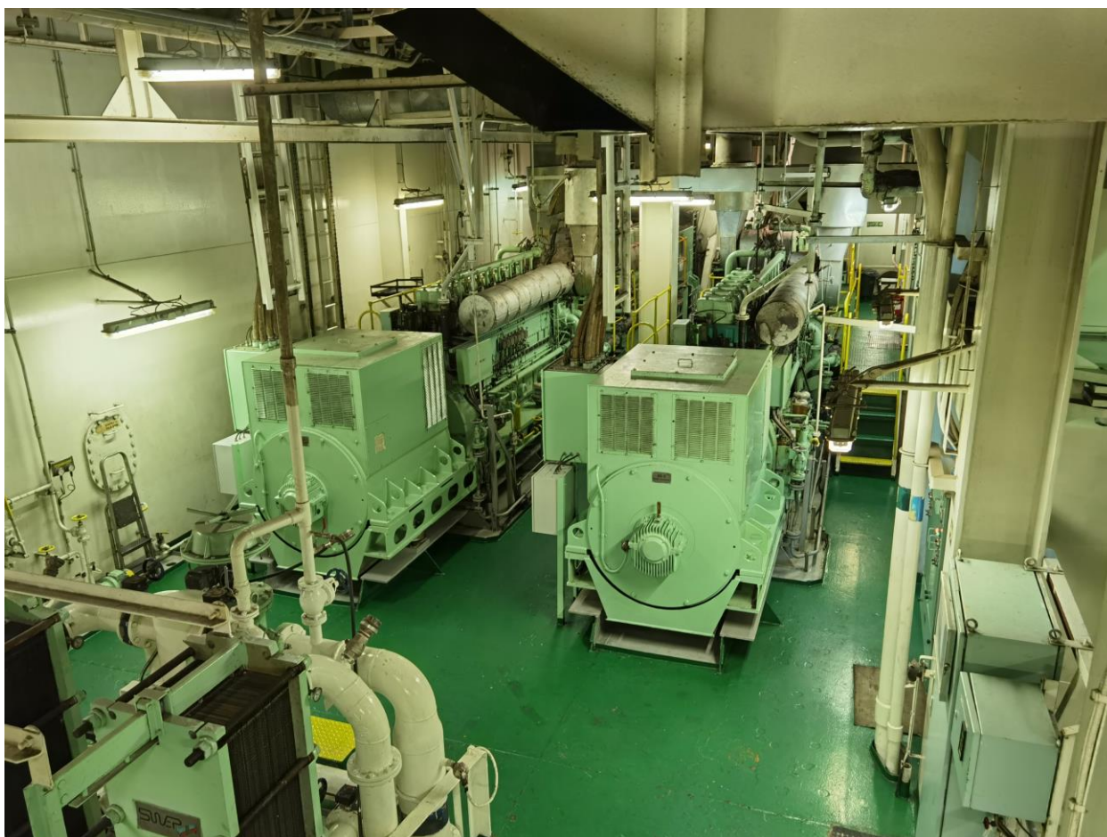
Slika 6.3. Generatori u strojarnici
