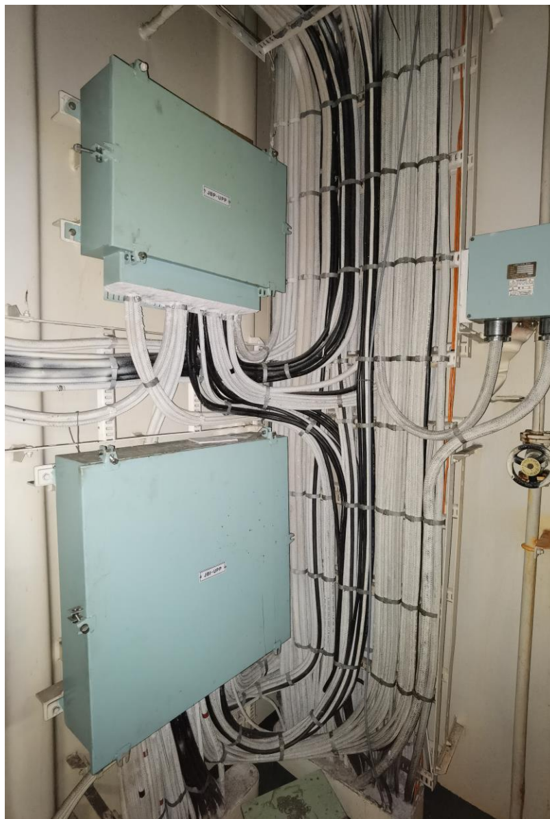
Slika 6.2. Instalacija kabela u „pipe-duck“ prostoriji
