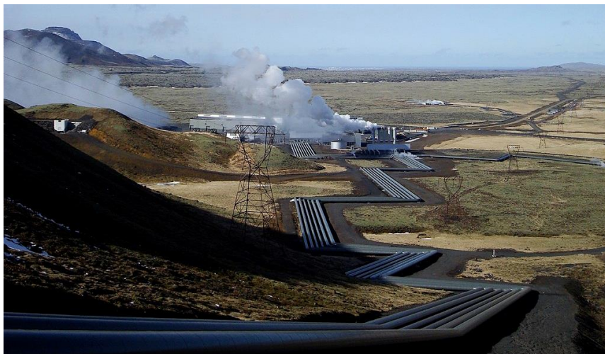
Slika 2.8. Geotermalna elektrana Hellisheiði (Island) [11]
