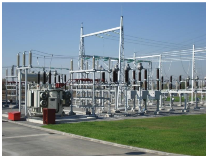
Slika 2.14. Vanjska izvedba trafostanice 110/35 kV Pokuplje [19]
