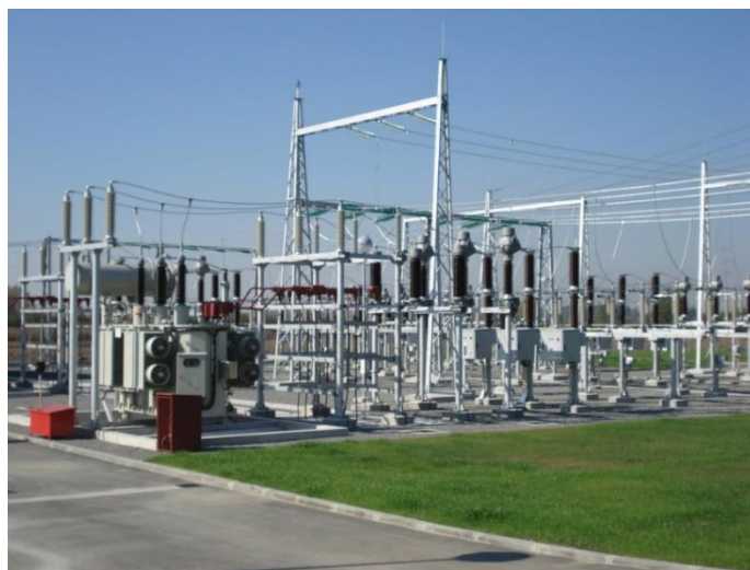
Slika 2.14. Vanjska izvedba trafostanice 110/35 kV Pokuplje [19]
