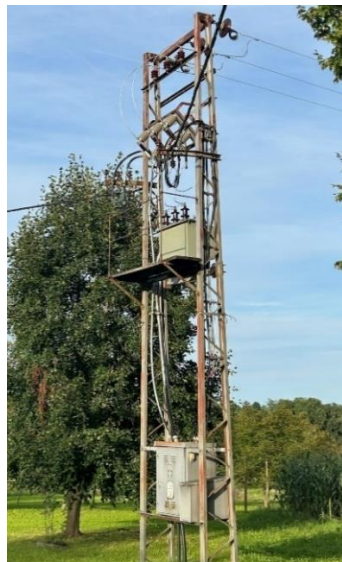
Slika 2.13. Stupna transformatorska stanica
