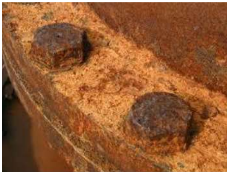
Slika 3.1. Opća korozija vijčanog spoja i prirubnice [9]
