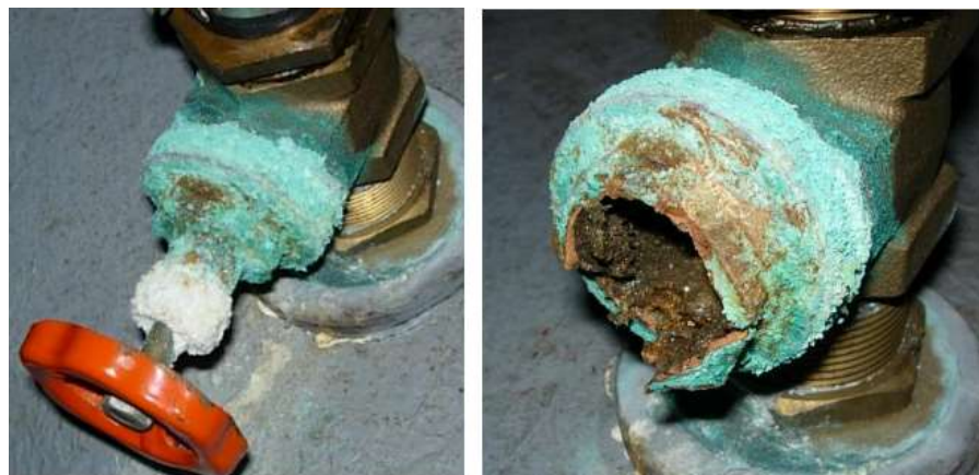
Slika 3.7. Primjer decinkacije mjedi i puknuća ventila [8]
