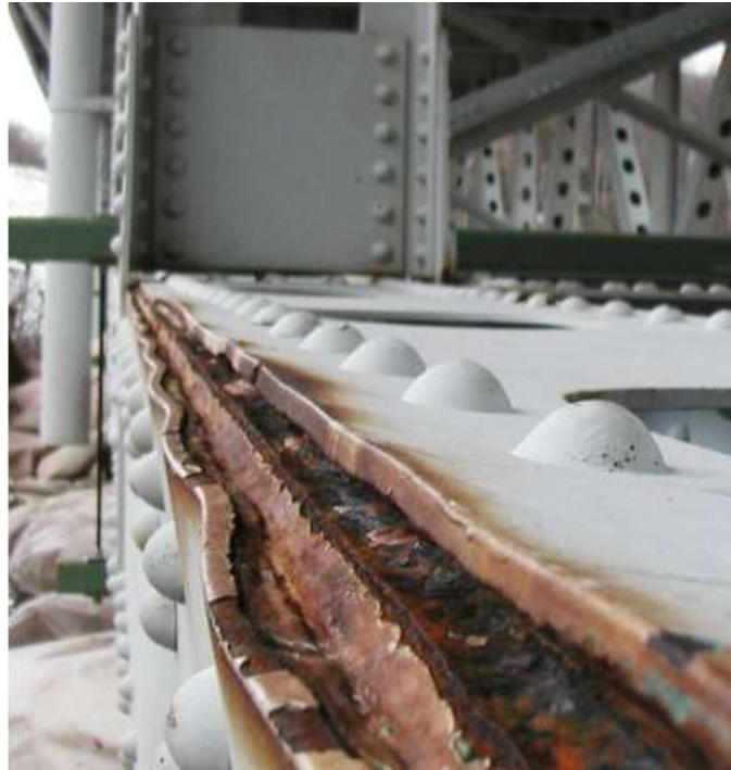
Slika 3.4. Primjer korozije u procijepu na konstrukciji mosta [8]
