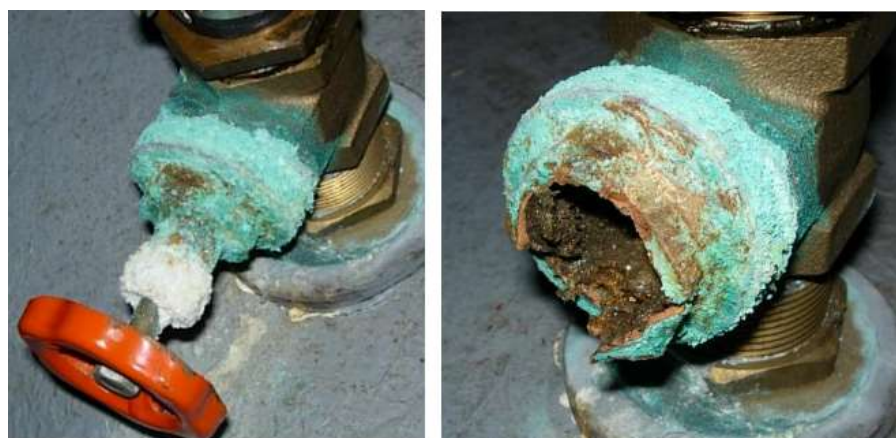
Slika 3.7. Primjer decinkacije mjedi i puknuća ventila [8]
