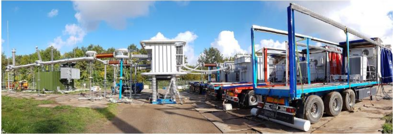
Slika 6.1. Ispitni sustav za ispitivanje dugih AC 400kV kabela [10]
