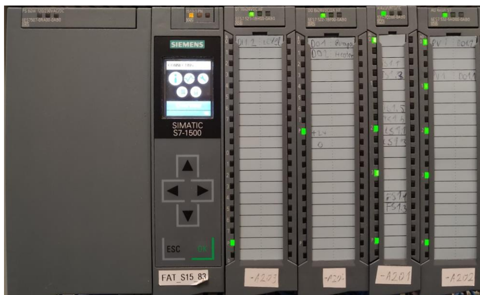
Slika 3.1. Siemens S7-1500 PLC s napajanjem i I/O karticama [Autor]
