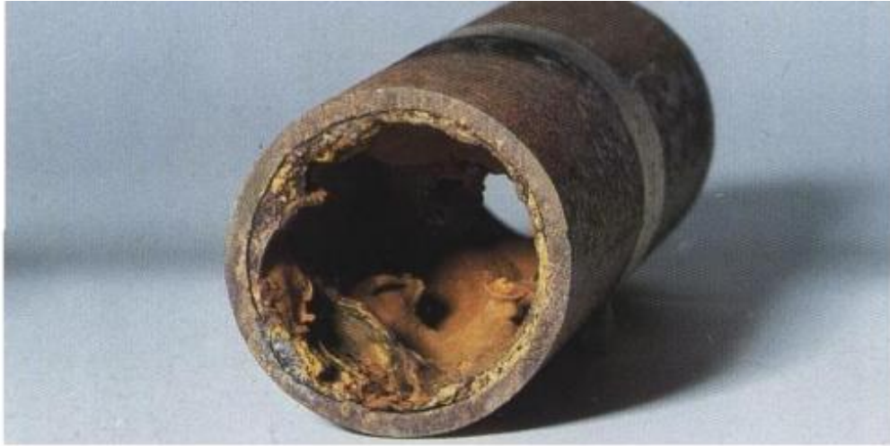
Slika 3.14 Bakterijska korozija ugljičnog čelika [8]
