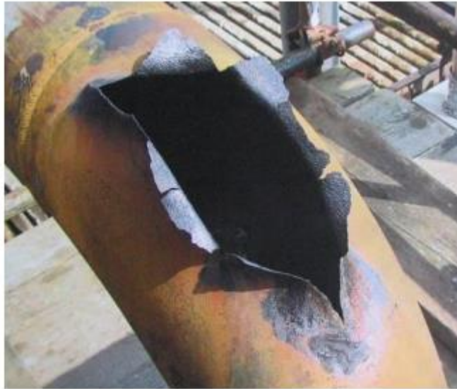
Slika 3.18 Oštećenje cijevi nastalo djelovanjem erozijske korozije [8]
