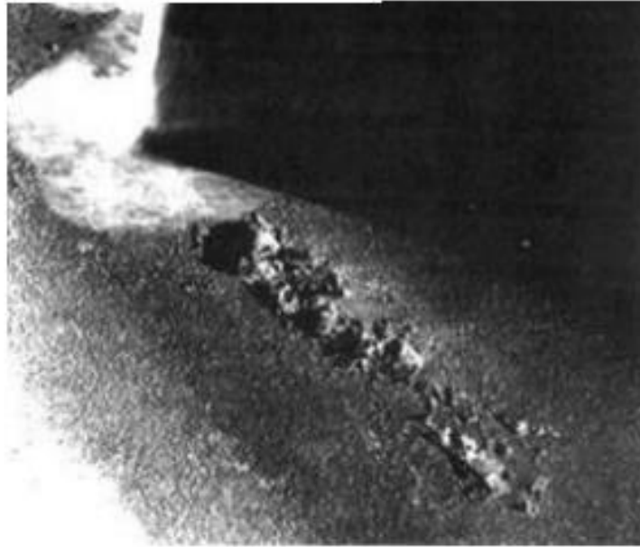
Slika 3.20 Oštećenje lopatice turbine uslijed kavitacijske korozije [8]
