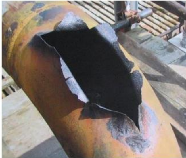
Slika 3.18 Oštećenje cijevi nastalo djelovanjem erozijske korozije [8]
