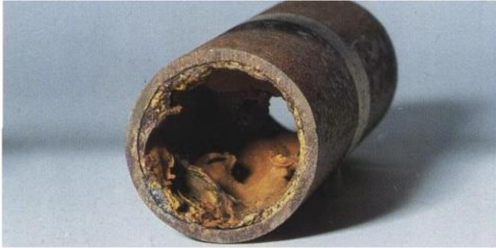
Slika 3.14 Bakterijska korozija ugljičnog čelika [8]
