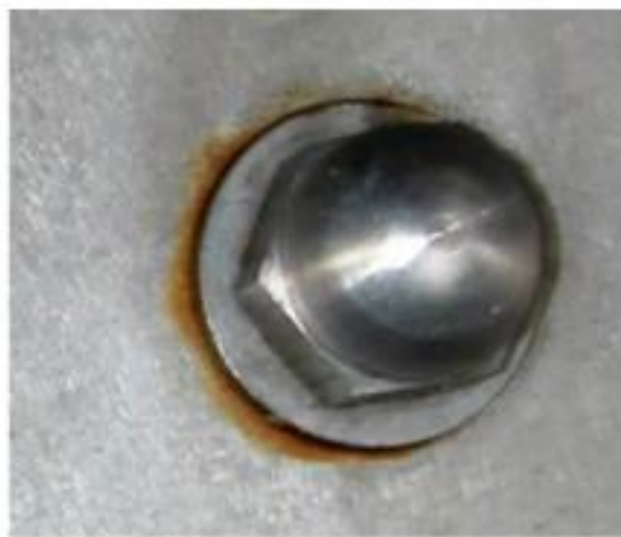
Slika 3.10 Oštećenje metala uslijed korozije u procijepu [8]
