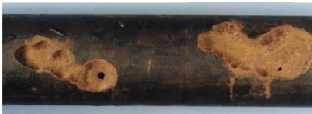
Slika 3.22 Oštećenje uslijed korozije djelovanjem lutajućih struja [8]
