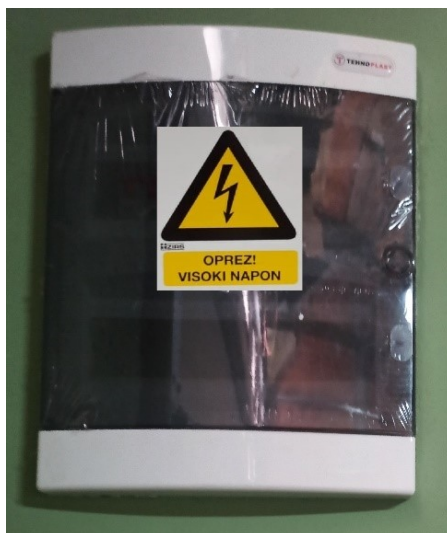
Slika 7.7. Vanjski izgled razvodnog ormara RO-skladište-garaža
