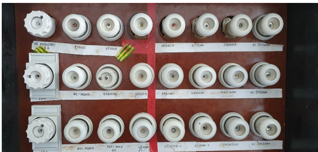
Slika 5.9 Rastalni osigurači DII ugrađeni unutar razvodnog ormara
