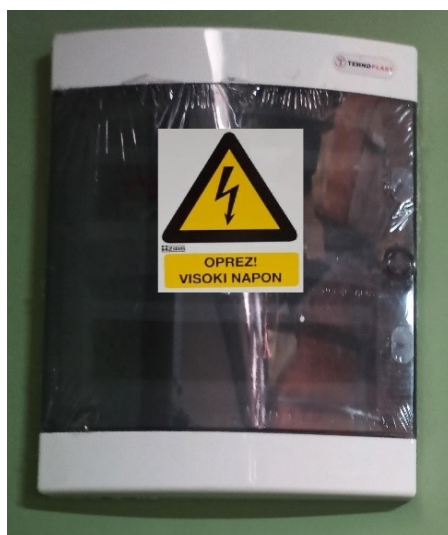
Slika 7.7. Vanjski izgled razvodnog ormara RO-skladište-garaža
