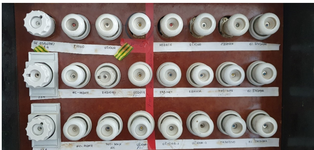
Slika 5.9 Rastalni osigurači DII ugrađeni unutar razvodnog ormara
