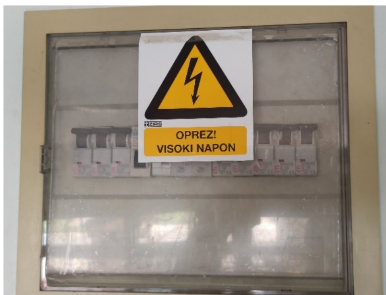
Slika 7.5. Oznake opasnosti na razvodnom ormaru u prodavaonici (RO-prodavaonica)
