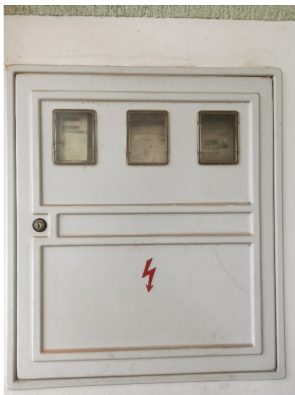
Slika 7.2 Glavni razvodni ormar građevine smješten u predvorju prodavaonice
