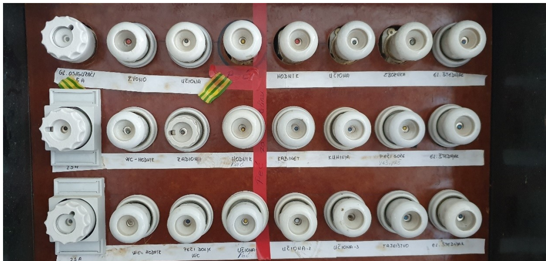
Slika 5.9 Rastalni osigurači DII ugrađeni unutar razvodnog ormara
