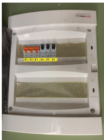
Slika 7.8. Izgled i oznake zaštitnih uređaja u razvodnom ormaru RO-skladište garaža
