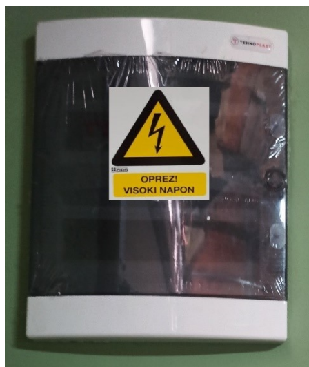
Slika 7.7. Vanjski izgled razvodnog ormara RO-skladište-garaža
