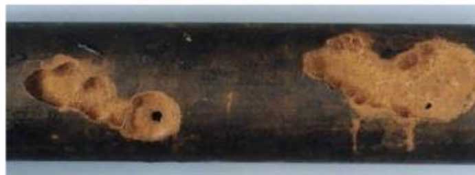
Slika 2.28.: Oštećenja uslijed djelovanja korozije lutajućih struja [3]
