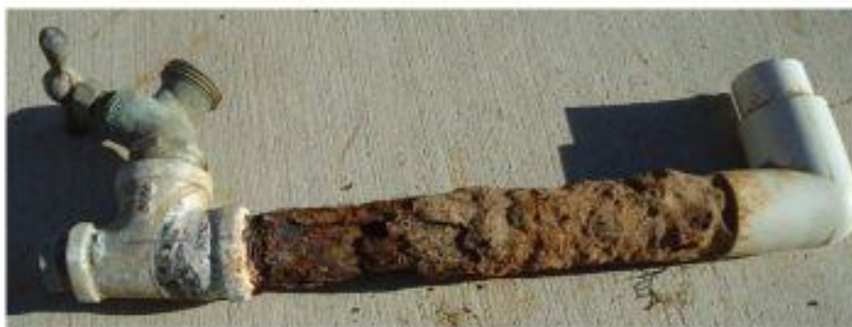
Slika 2.18.: Galvanska (kontaktna, bimetalna) korozija [3]
