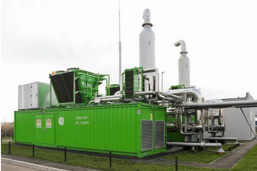
Slika 5.1 Kontejnerska izvedba "Jenbacher" plinskog motora [20]
