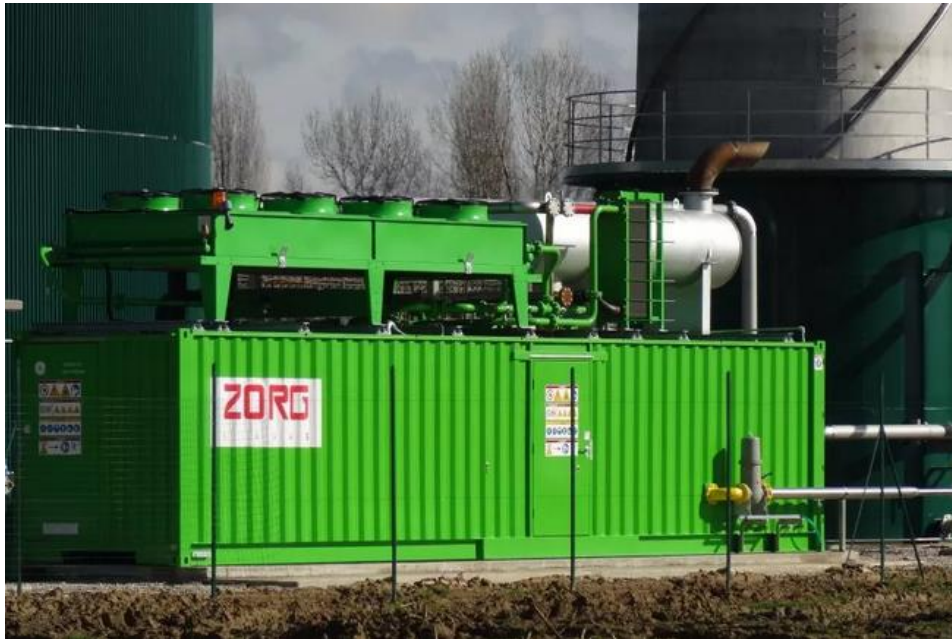
Slika 6.8 Jenbacher JMC 312 GS-B.L. u kontejnerskoj izvedbi [28]
