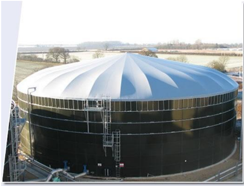
Slika 6.6 Membranski spremnik digestata
