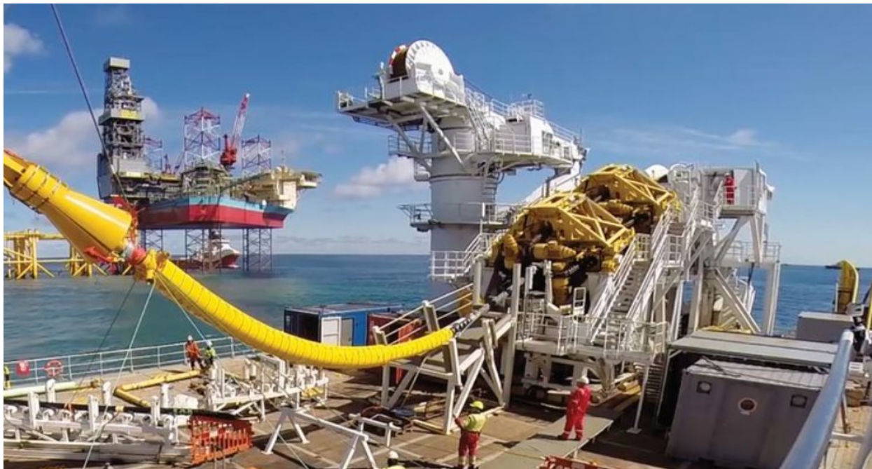
Slika 3.4. Podmorski AC kabel najveće duljine na svijetu ( l=163 km) [15]
