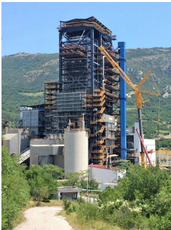
Slika 13. Kotlovsko postrojenje bloka 2 [5]
