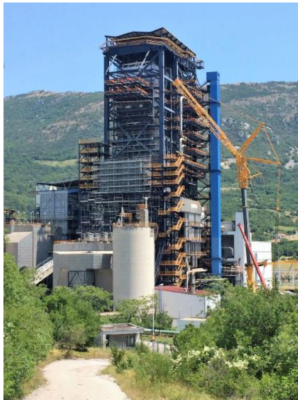
Slika 13. Kotlovsko postrojenje bloka 2 [5]
