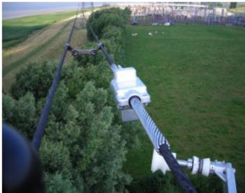
Slika 5.16. Senzor Ampacimon postavljen na 400 kV vod [42]
