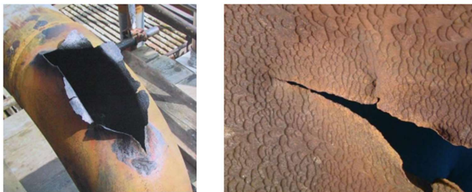
Slika 4.10: Erozijsko oštećenje cjevovoda za transport nafte [10]
