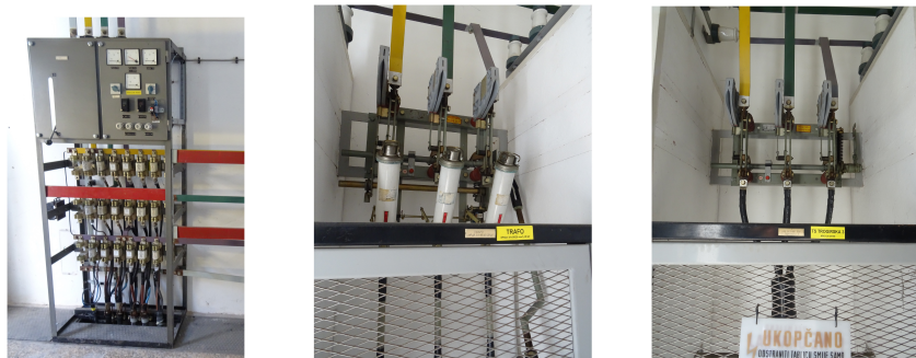
Slika 2.3. Zastarijela izvedba NN i SN postrojenja [4]
