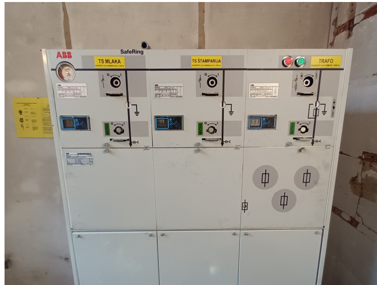
Slika 2.4. ABB SN sklopni blok [4]
