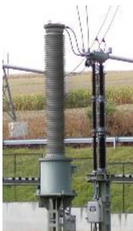
Slika 3.26. Naponski transformator izoliran plinom SF 6 [20]
