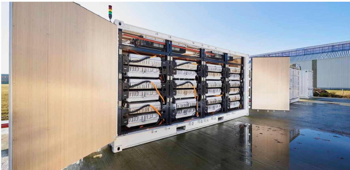
Slika 4. 2 Baterijski sustav pohrane za distribucijsku mrežu [3]
