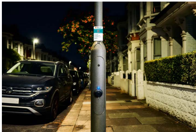
Slika 6.1 Stup s ugrađenim priključkom za punjenje vozila
