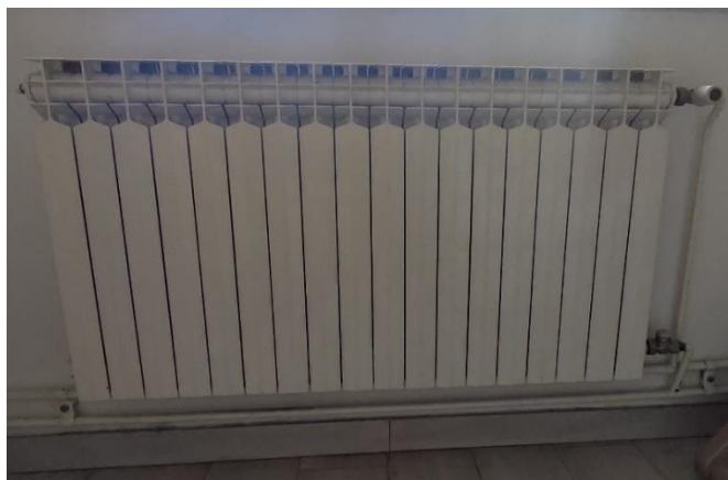
Slika 5.1. Izgled radijatora proizvođača Lipovica tip SOLAR 500/80 u obiteljskoj kući
