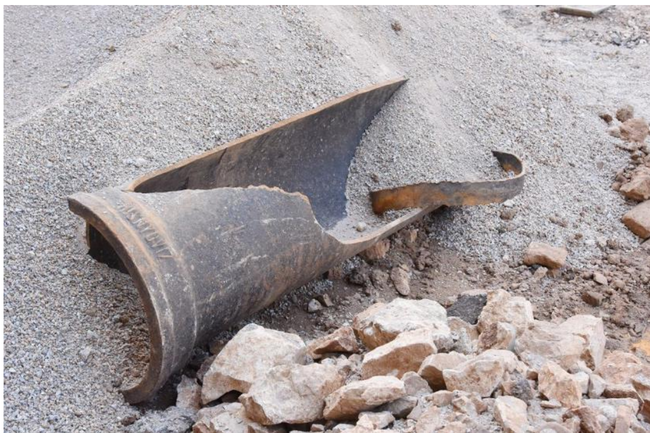
Slika 2.1 Prikaz puknute cijevi [3]
