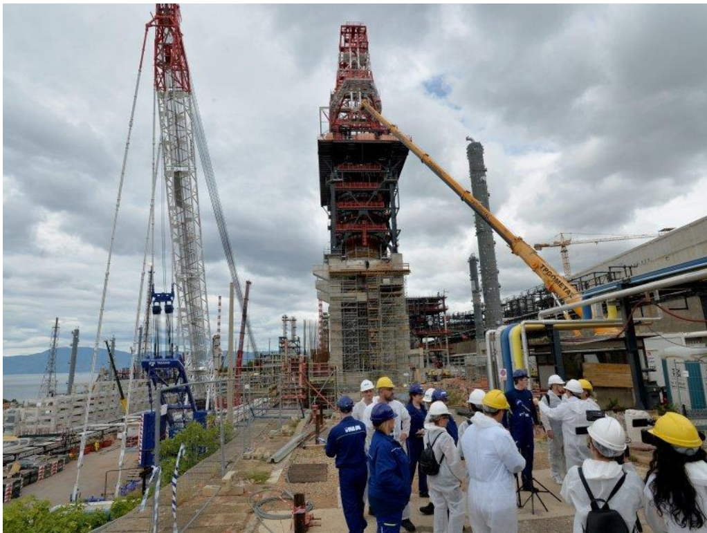
Slika 11 - Postrojenje za obradu teških ostataka[6]
