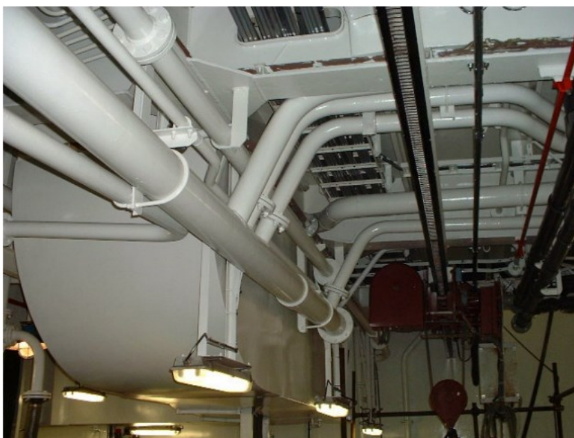
Slika 3.7. Detalj smještaja cjevovoda u strojarnici [11]
