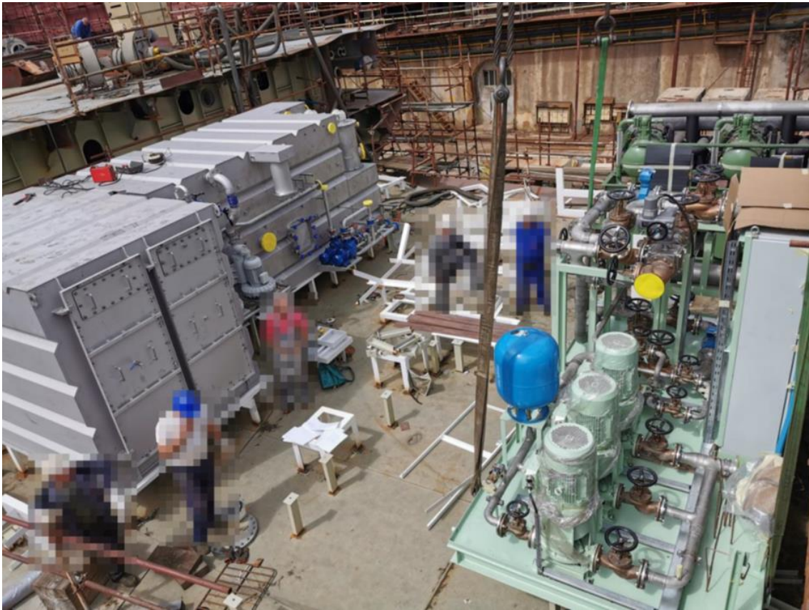
Slika 29. Oprema u sewage treatment roomu
