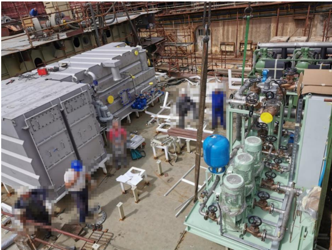
Slika 29. Oprema u sewage treatment roomu
