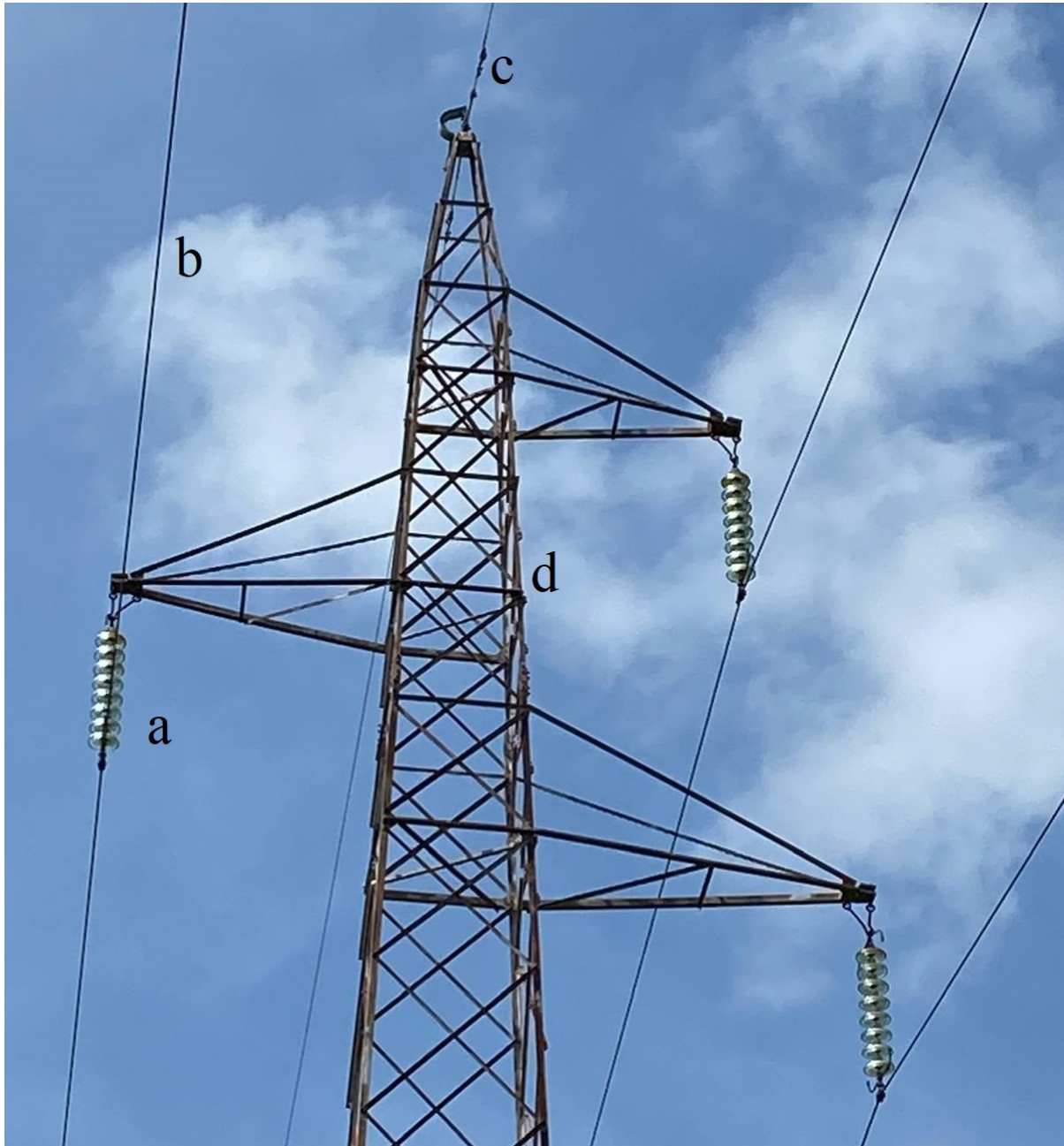
Slika 2.5. Dijelovi nadzemnih vodova: a) izolatori, b) fazni vodič, c) zaštitno uže, d) stup [DV Šijana-Raša, vlasništvo autora]
