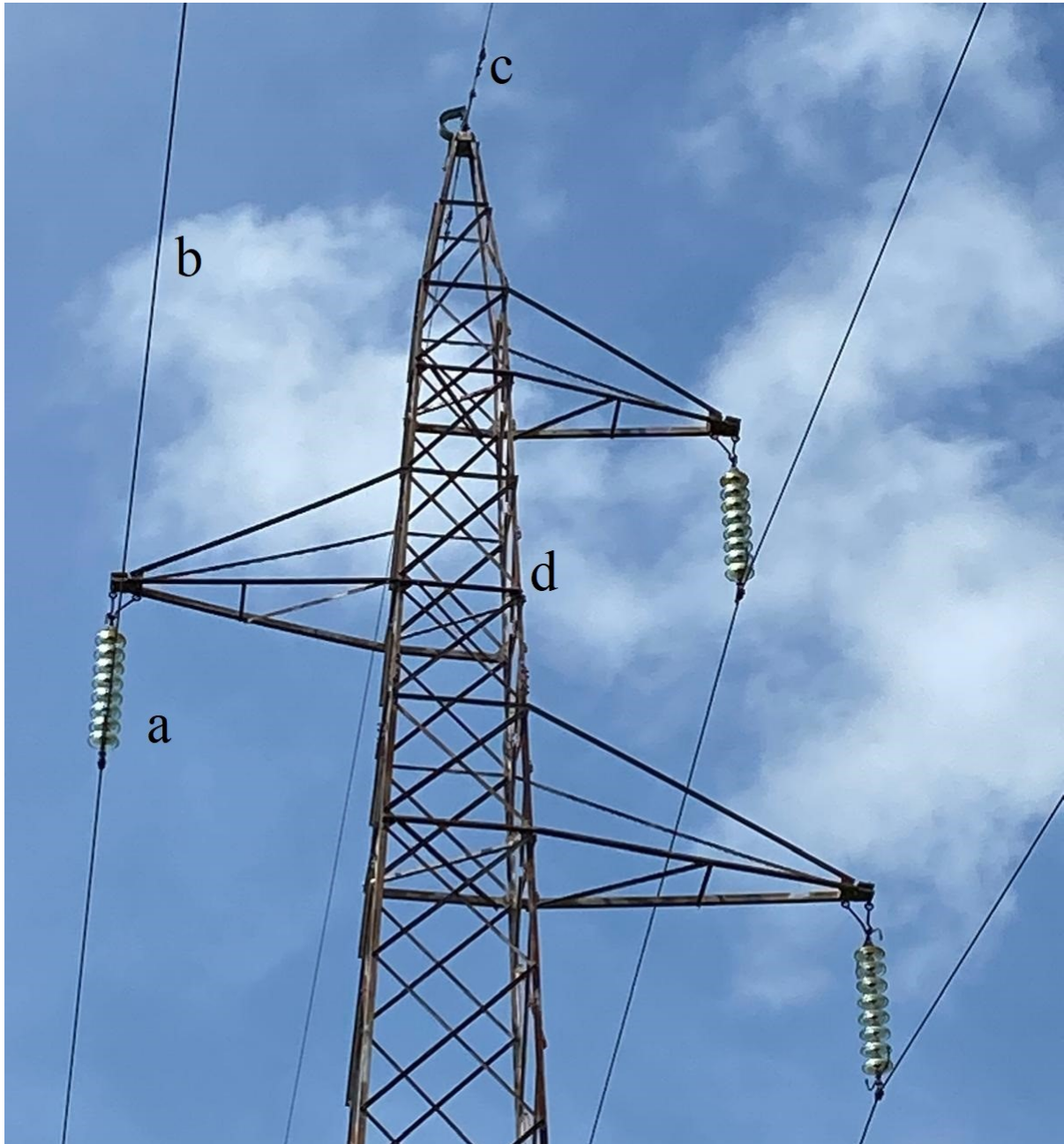
Slika 2.5. Dijelovi nadzemnih vodova: a) izolatori, b) fazni vodič, c) zaštitno uže, d) stup [DV Šijana-Raša, vlasništvo autora]
