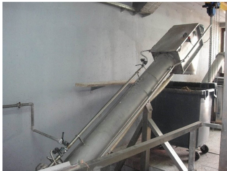
Slika 3.2. Prikaz otpusta krutog otpada finog sita u komunalni kontejner
