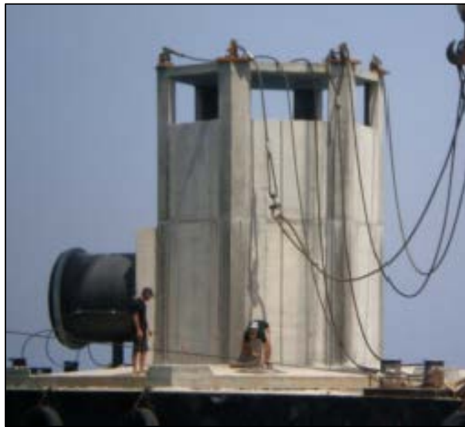
Slika 3.1 Usisno postrojenje (Alžir) [8]
