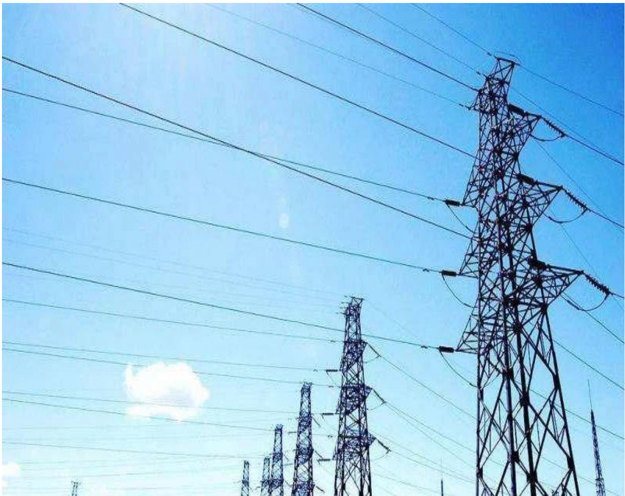
Slika 2.1 Nadzemni elektroenergetski vod
