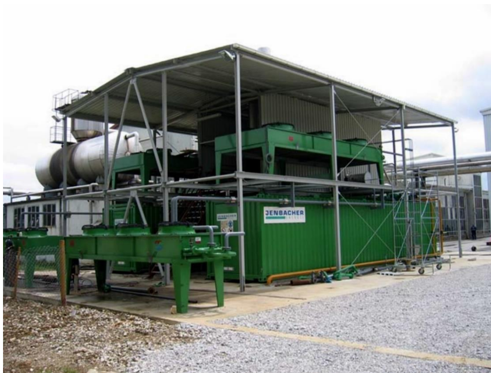
Slika 4.1. Kogeneracijsko postrojenje s plinskim motorima u Gavriloviću [20]
