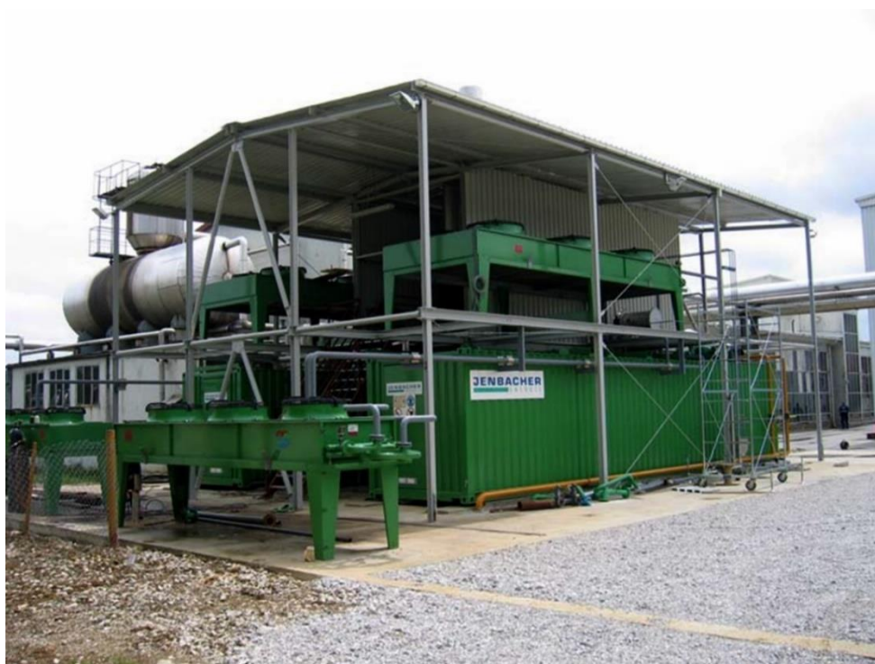
Slika 4.1. Kogeneracijsko postrojenje s plinskim motorima u Gavriloviću [20]
