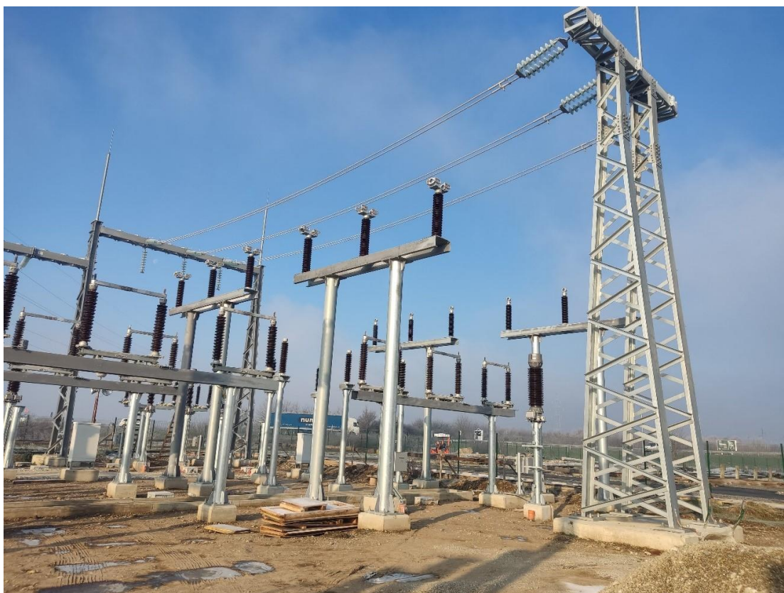
Slika 3.2. AIS postrojenje 110 kV [12]
