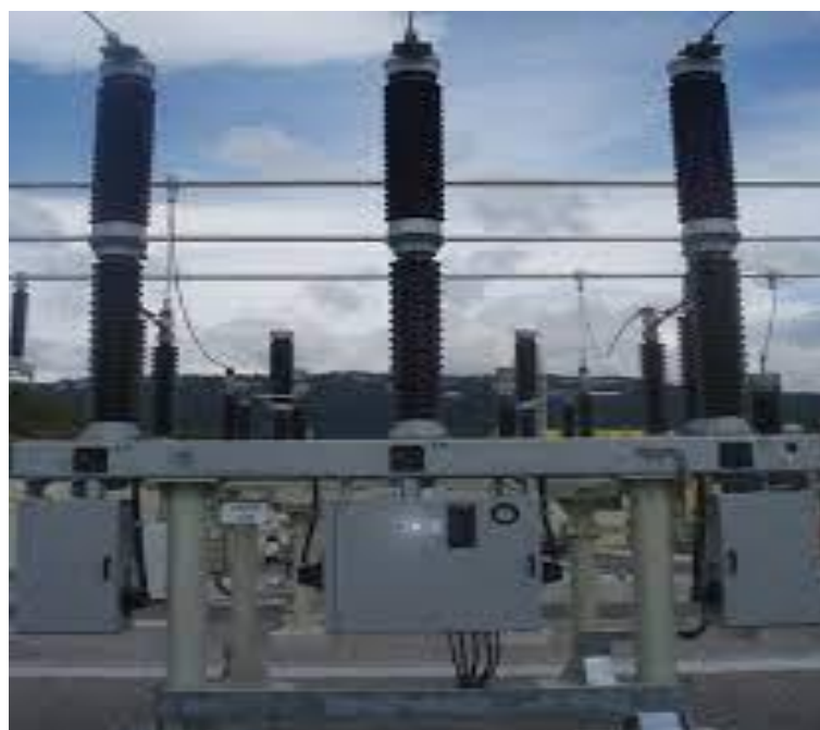
Slika 2.3. 110 kV SF 6 prekidač [4]
