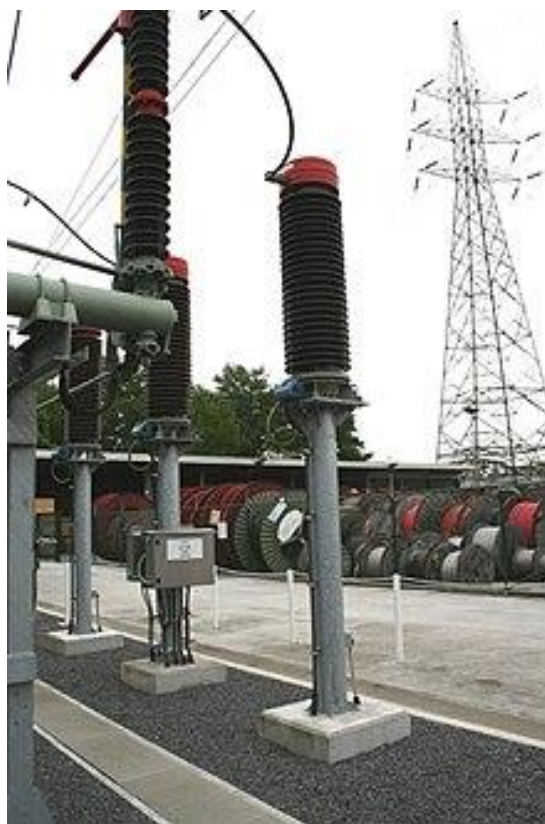
Slika 2.4. Naponski mjerni transformator na 110 kV [5]
