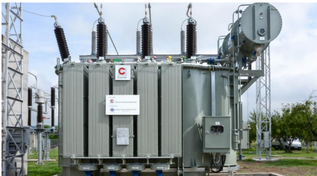
Slika 2.7. Transformator 110/x kV [8]
