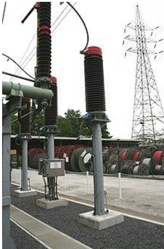
Slika 2.4. Naponski mjerni transformator na 110 kV [5]
