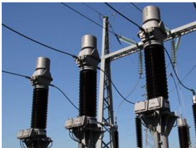
Slika 2.6. Kombinirani mjerni transformator visokog napona [7]
