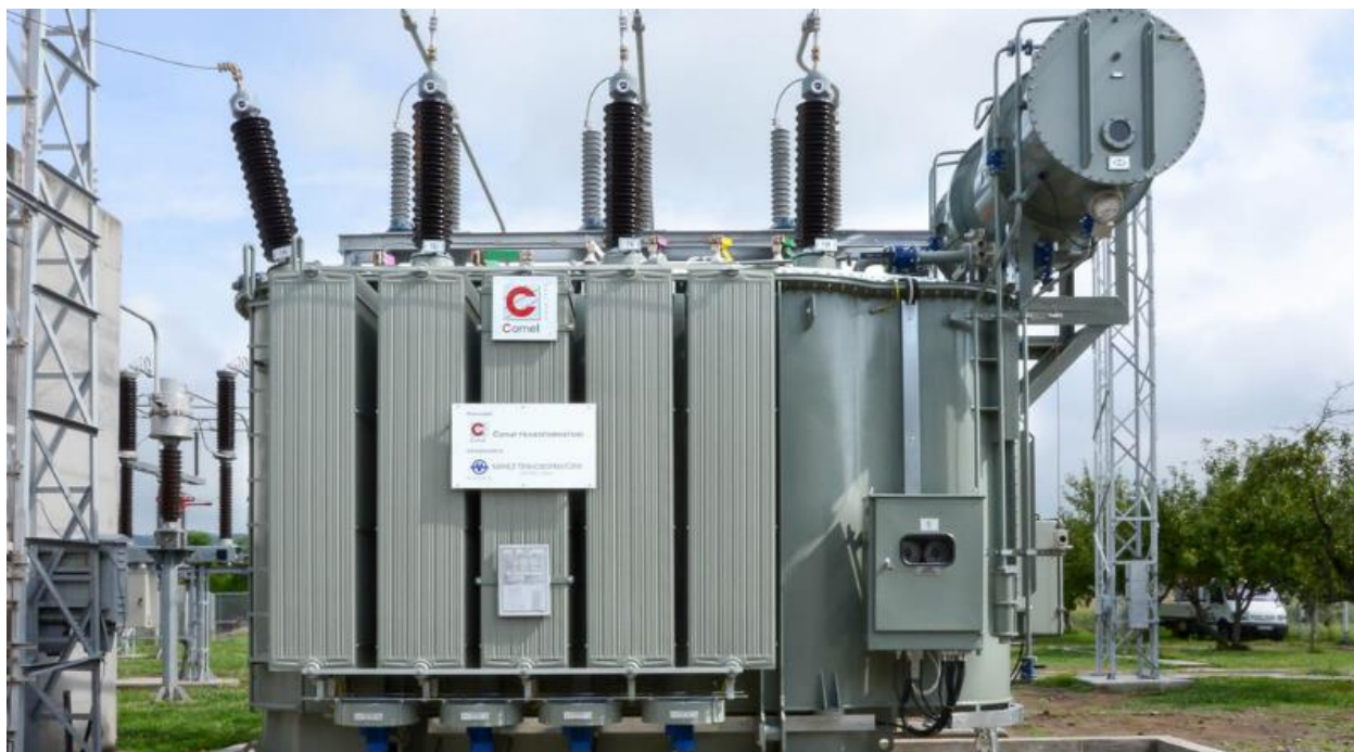
Slika 2.7. Transformator 110/x kV [8]
