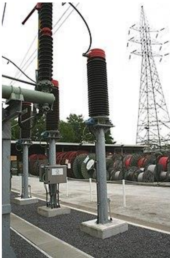
Slika 2.4. Naponski mjerni transformator na 110 kV [5]
