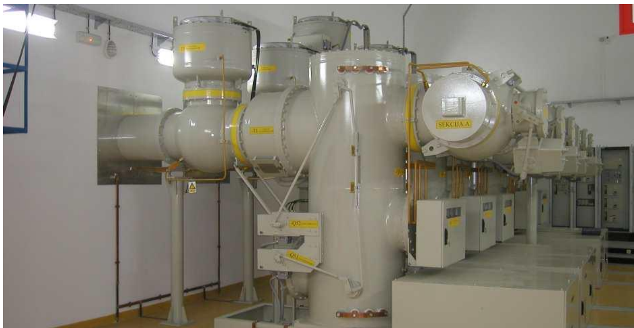
Slika 3.1. GIS postrojenje 110 kV proizvođača Končar [11]
