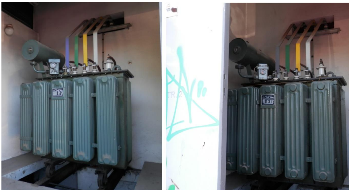
Slika 3.1. Zastarjeli energetski transformatori koje je potrebno zamijeniti
