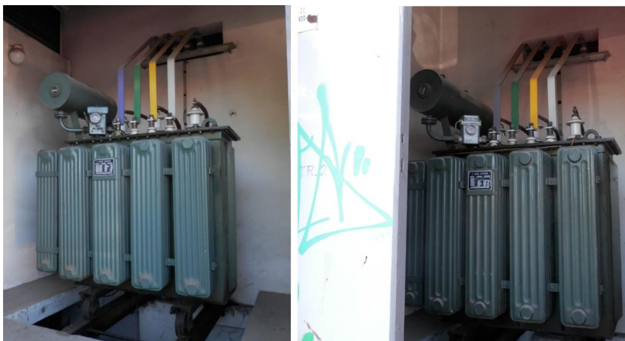
Slika 3.1. Zastarjeli energetski transformatori koje je potrebno zamijeniti
