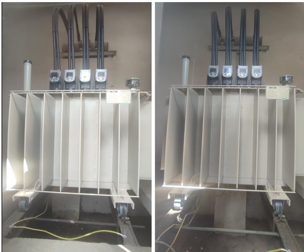
Slika 3.2. Novo ugrađeni transformatori s moderniziranom tehnologijom
