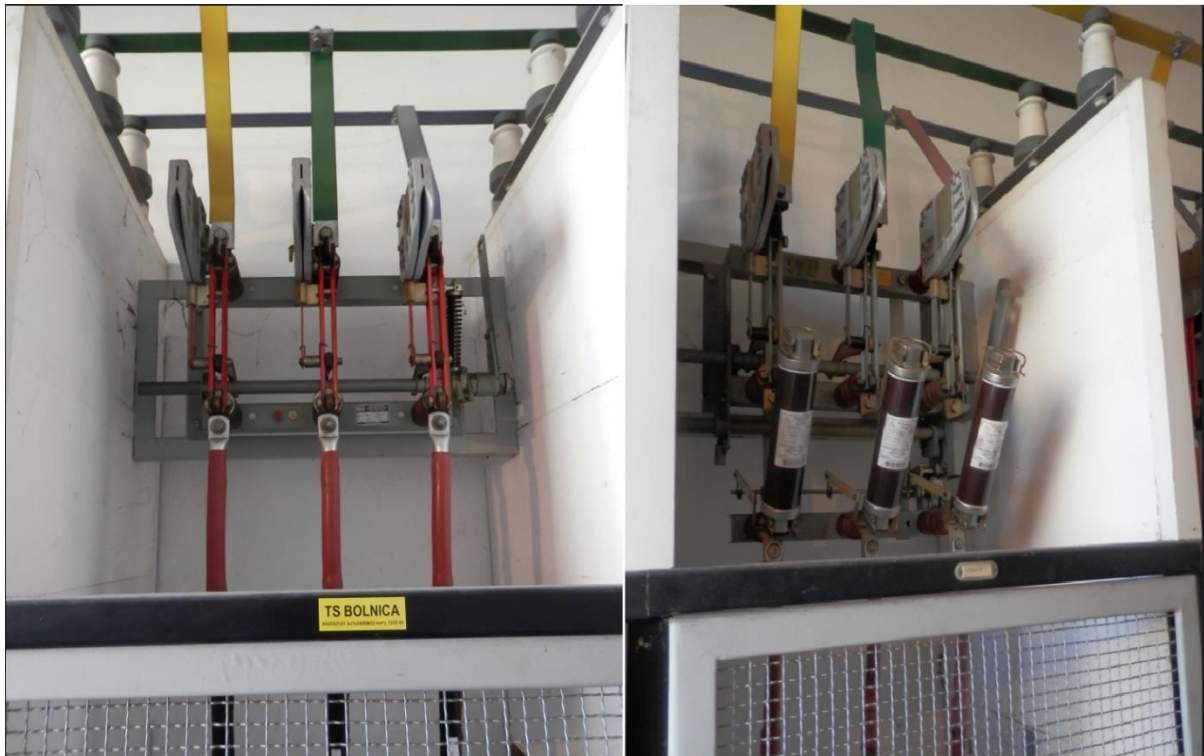
Slika 3.4. Izgled srednjenaponskog sklopnog postrojenja koje je potrebno zamijeniti zbog zastarjelosti opreme
