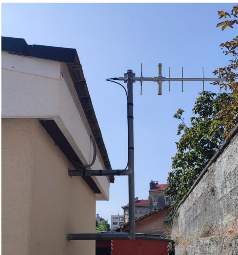
Slika 6.4. Antena na transformatorskoj stanici za poboljšanje radio veze
