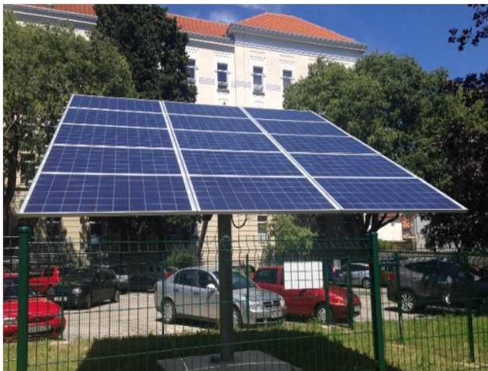
Slika 5.18. Fotonaponska elektrana RITEH 1[17]
