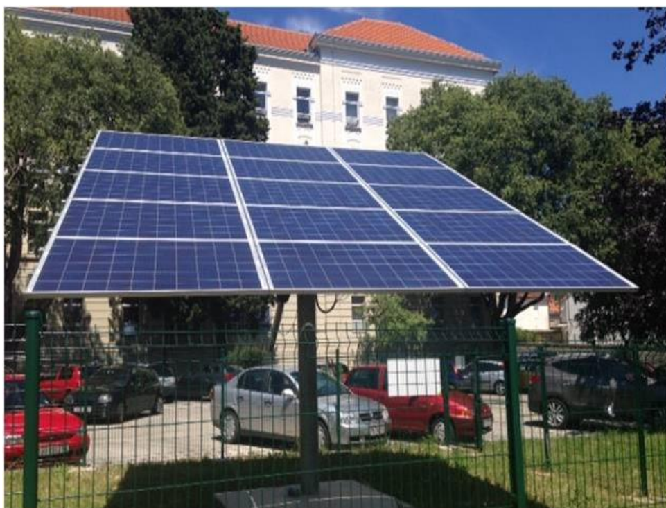
Slika 5.18. Fotonaponska elektrana RITEH 1[17]
