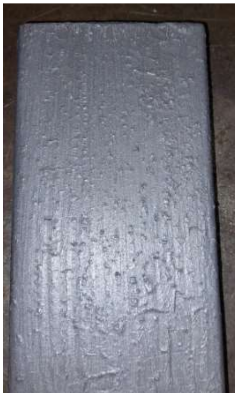
Slika 4.24 Primjer nekompatibilnog završnog premaza sa međupremazom
