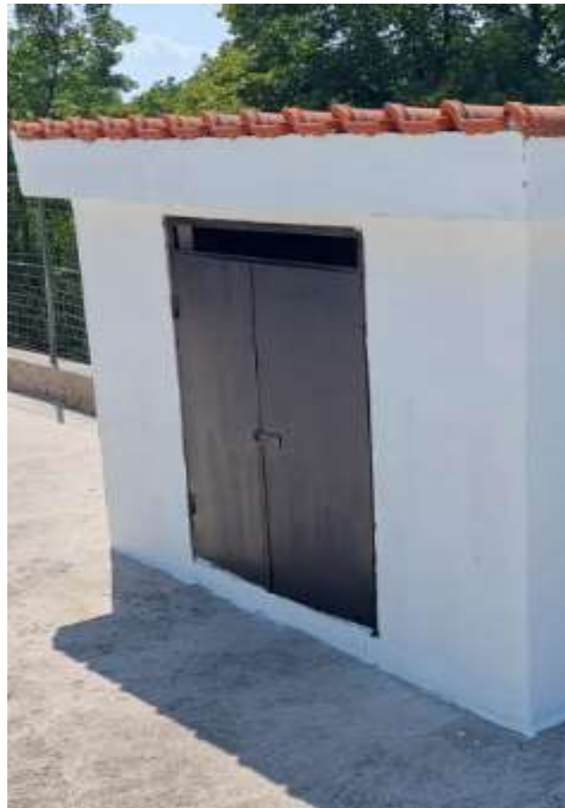
Slika 4.23 Primjer akrilne boje na čeličnim limenim vratima
