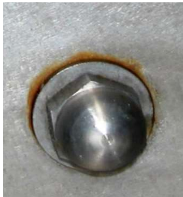
Slika 3.7 Primjer korozije u procjepu [9]
