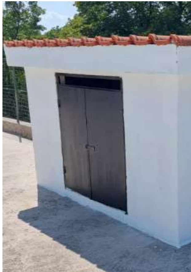
Slika 4.23 Primjer akrilne boje na čeličnim limenim vratima
