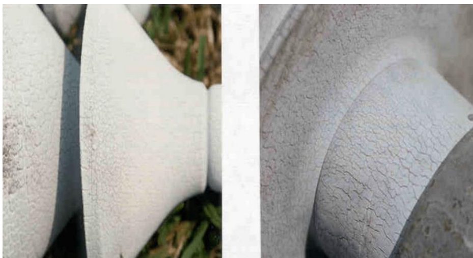
Slika 5.9. Pukotine manje od 0,1 mm[13]
