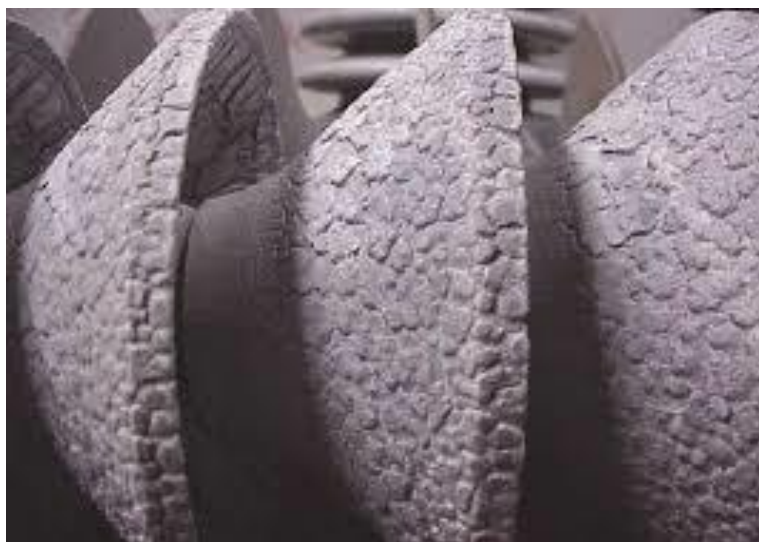
Slika 5.10. Aligatoring površine polimernog izolatora[13]
